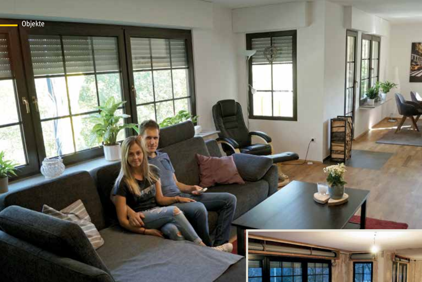
Vorher und nachher im direkten Vergleich: Im Zuge der Renovierung wurden nicht nur Rollladenkästen gedämmt und Rollladenpanzer erneuert. Die Behänge wurden auch mit modernster Funktechnik bestückt.
