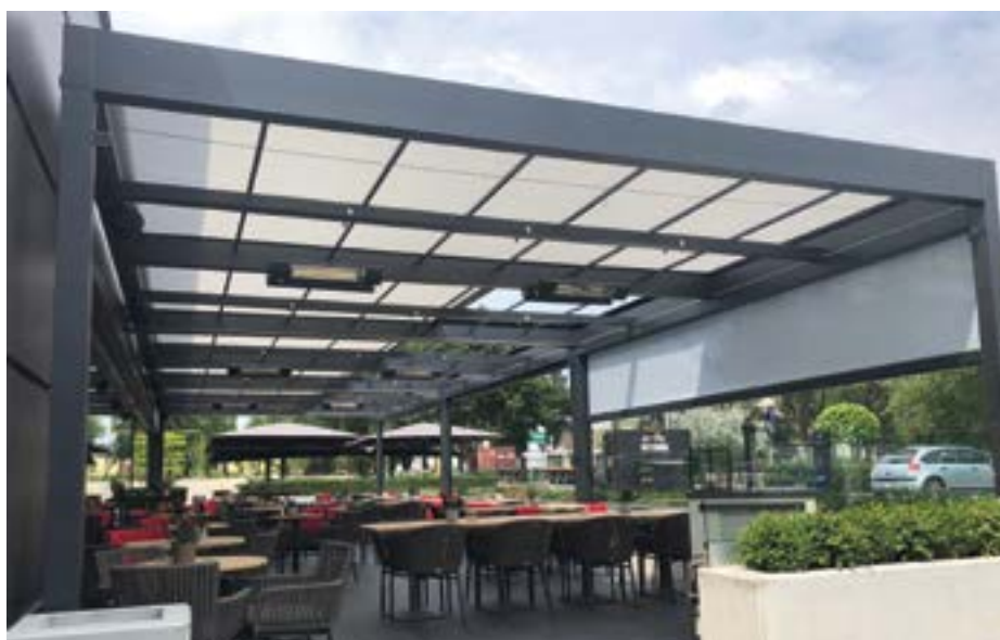
Die Anlage des Hotels ist zusätzlich mit LED Lines, mit LED Spots und Wärmestrahlern ausgestattet.
