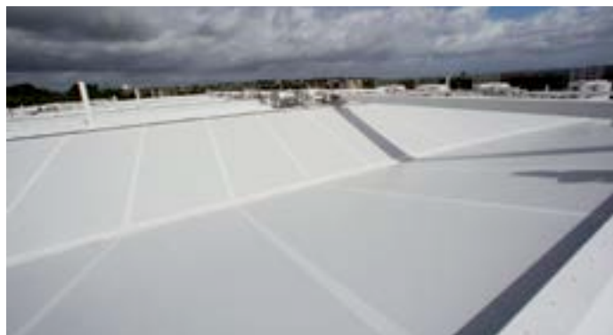
Im Wimbledon Centre Court spielt das im fahrbaren Dach des historischen Stadiongebäudes aus dem Jahr 1922 verarbeitete Gewebe alle seine ästhetischen und funktionalen Vorzüge aus.
