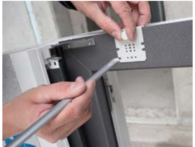
Im nächsten Schritt werden zur Befestigung der außen liegenden Führungsschienen Nippelschrauben in vorgegebenen Abständen auf den Blendrahmen des Fensters aufgeschraubt.
