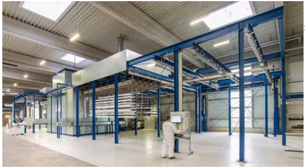
Für die neue Beschichtungsanlage hat das Unternehmen eigens eine neue Produktionshalle errichtet. Die Maschine umfasst Komponenten zur Vorbehandlung, zur Beschichtung sowie zwei Öfen.
