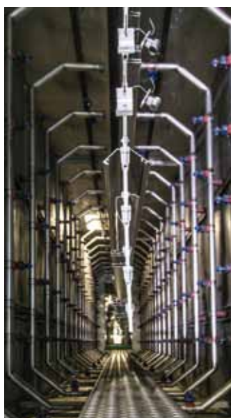
Ein Blick in die Station zur chemischen Vorbehandlung.
