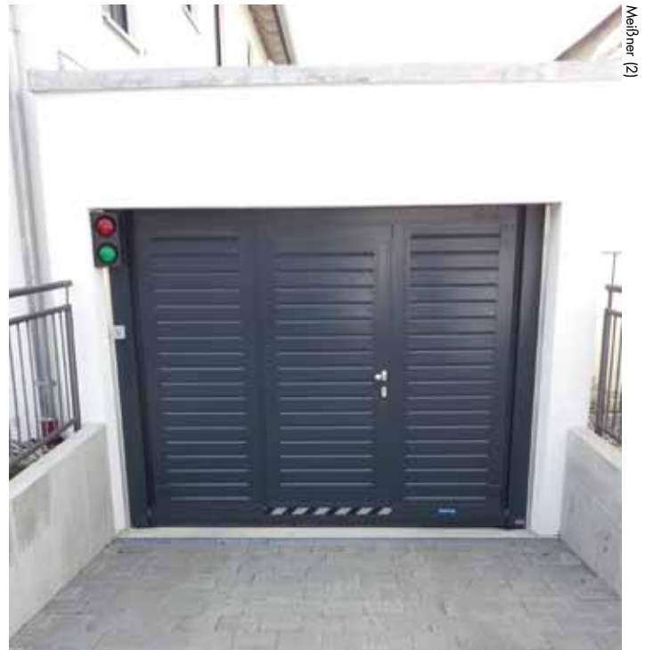
Sämtliche Gefahrenpunkte sind bei den Toren abgesichert.
