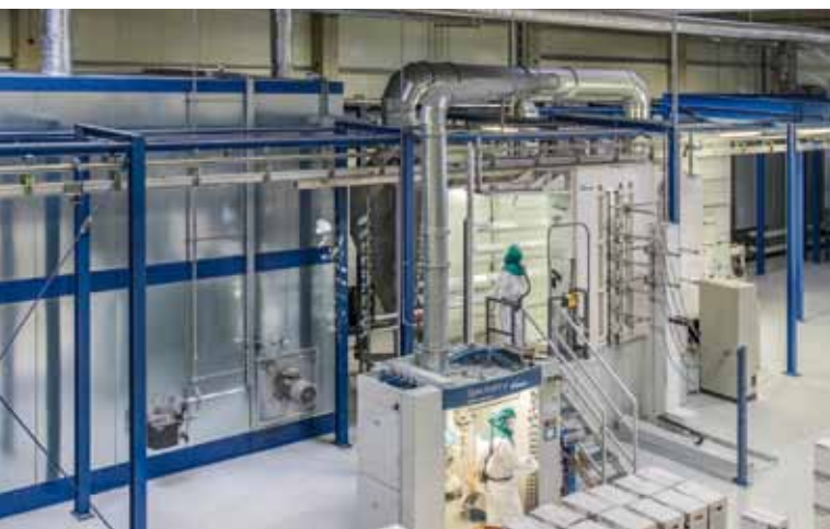
Die Beschichtungsanlage kann nahezu alle Farbtöne verarbeiten – im Vordergrund sind die Kartons mit dem Farbpulver zu sehen.
