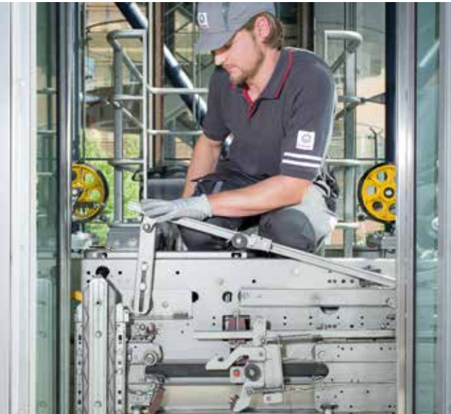
Techniker bei der Wartung Technician engaged in maintenance
