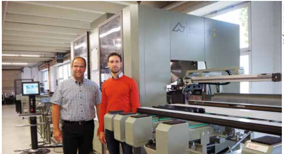
Thomas Fischer (l., Emmegi) und Jonas Swiatek (Timm Fensterbau) vor dem frisch installierten Durchlaufzentrum.
