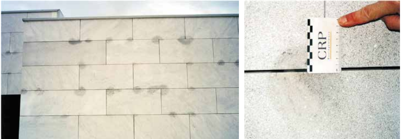
Bild 3 und 4: Natursteinfassade mit 6 mm breiten offenen Fugen zwei Tage nach Schlagregenbeaufschlagung.
