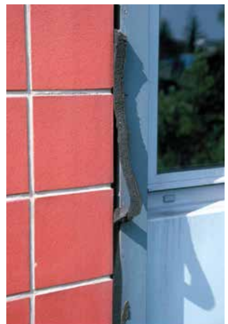
Bild 9: Leicht aus der Fuge herauszuziehendes, unzureichend komprimiertes Dichtungsband
