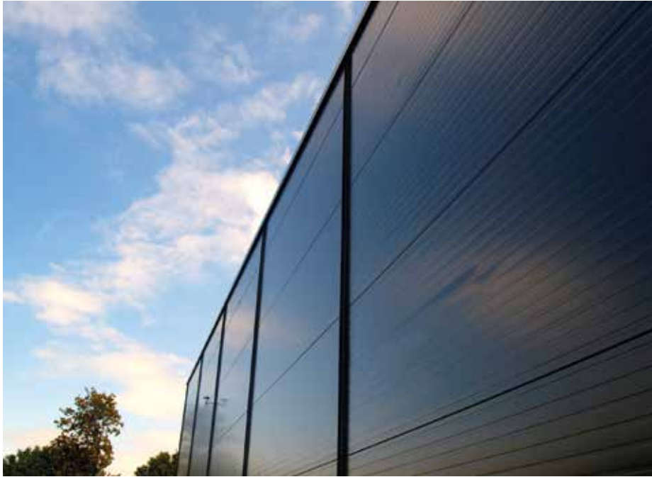
Bild 2: Logistikhalle und Büro in Lübeck: Die Wandaufbauten bestehen aus horizontal verlegten PIR/PUR Stahlsandwichelementen, in die solarthermische Leitungen integriert wurden. Die Gesamtfläche beträgt 220 m 2 , die dunkle Beschichtung soll den Ertrag erhöhen. Die gewonnene Energie wird als Vorlauf zur Wärmepumpe genutzt.
