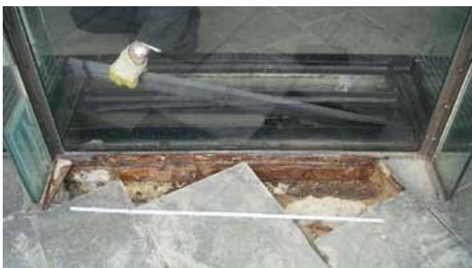
Korrosion am Fassadensockel.
