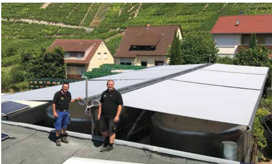
Die beiden Geschäftsführer des ausführenden Unternehmens freuen sich über ein gelungenes Projekt.
