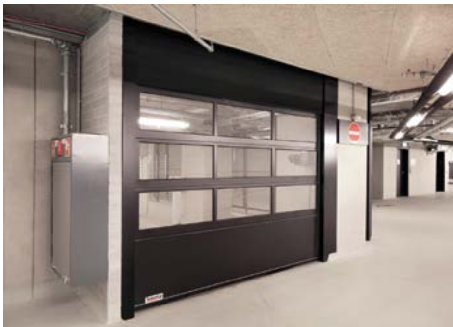
Die Ausfahrt aus dem privaten Teil der Tiefgarage ist mit einem Tor mit eleganter Streckmetallfüllung ausgestattet.
