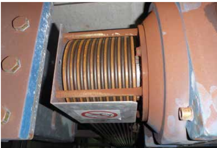
Verschleiß des Antriebes Wear of the drive
