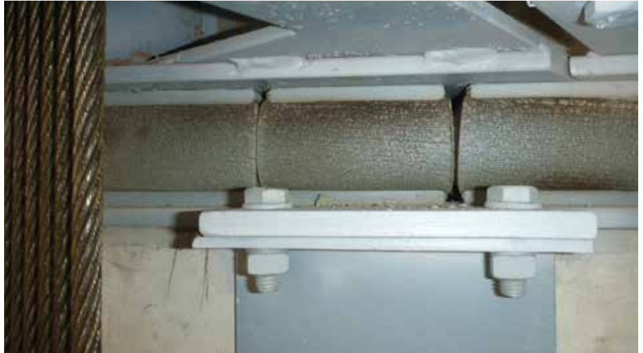
Zu geringer Abstand der Schwingungsisolierungen / Insufficient distance of oscillation insulation
