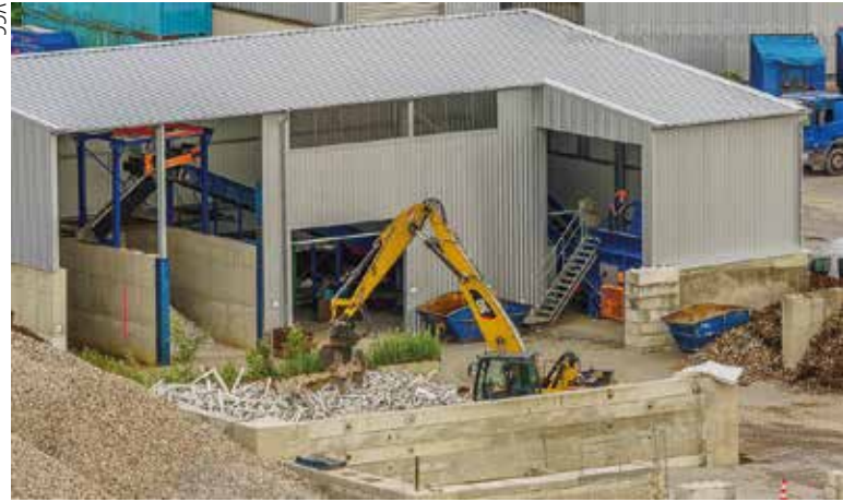
Die ausgebauten PVC-Fenster werden in der Altfensteranlage für eine weitere Veredelung im Recyclingprozess vorbehandelt.
