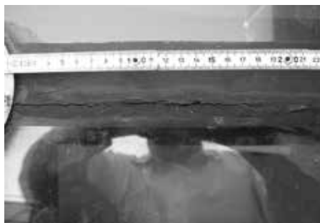
Schaumstofffüllung, Flüssigsilikonauffüllung oben. Deutlich sichtbar sind Hohlräume beidseitig und unterhalb der Schaumstoffprofile.
