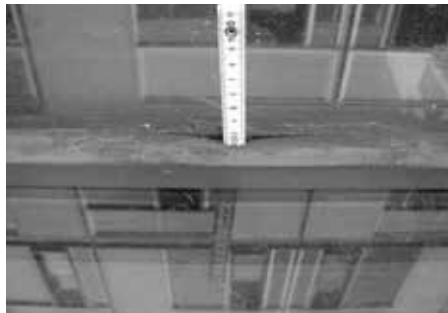
Riss in einer Silikonfuge, das Trägerprofil ist ebenfalls beschädigt.
