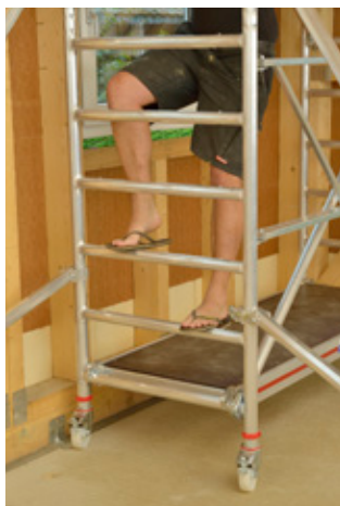
So ist es falsch: Wer das Gerüst mit ungeeignetem Schuhwerk betritt, läuft Gefahr, von den Gerüstspalten abzurutschen oder sich an den ungeschützten Füßen zu verletzen.
